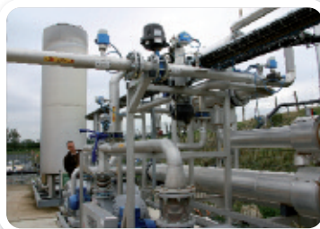
Surpresseur d'air, tuyaux de transport du biogaz et torchère
