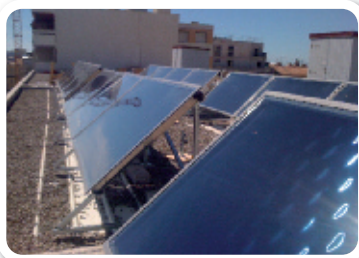
Capteurs installés en toiture terrasse
