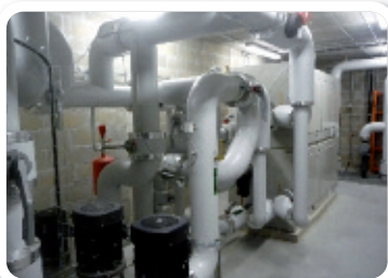
Chauffage par pompe à chaleur géothermique à la société PLACO SEFALOG (45)
