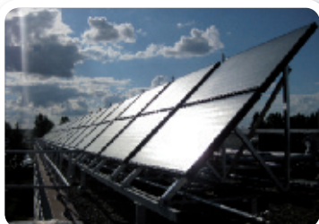
Une partie des capteurs installés en toiture-terrasse
