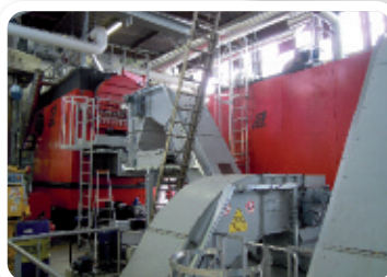
La centrale thermique rénovée
